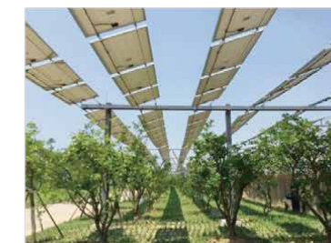
光伏發電項目 目前山東和河南已建第一批光伏項目 6 個，在建第二批光伏項目 2 個
