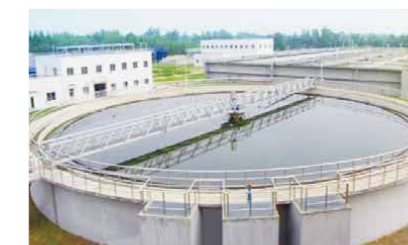
商丘水務有限公司污水處理廠一角
