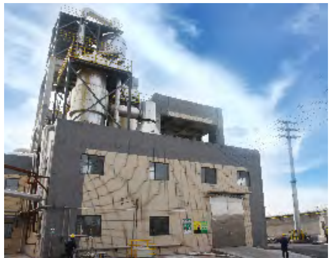
2500t/d硫酸钠MVR蒸发脱盐系统
