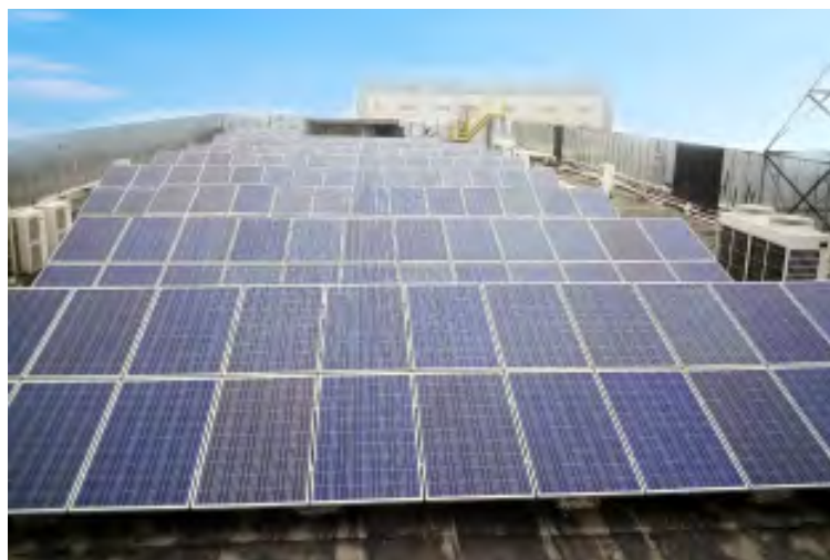
荆门园区太阳能光伏板
