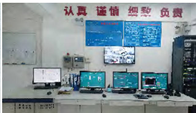
制氢站自动化控制办公室
