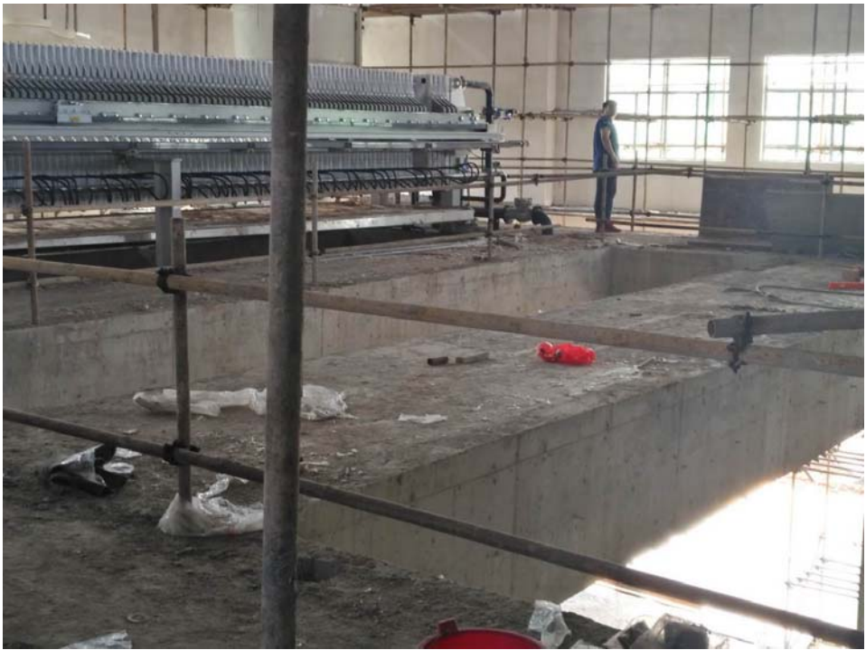
脱水机房现场图 图 6.6-2
