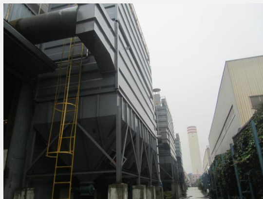
郑州煤机综机设备有限公司北区结构件分厂焊接烟尘治理
