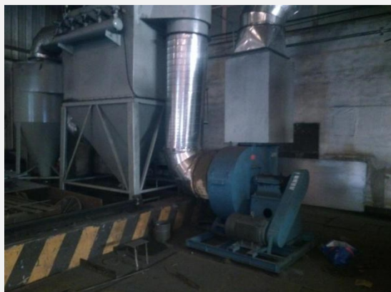
郑州煤机综机设备有限公司北区结构件分厂数控切割烟尘治理
