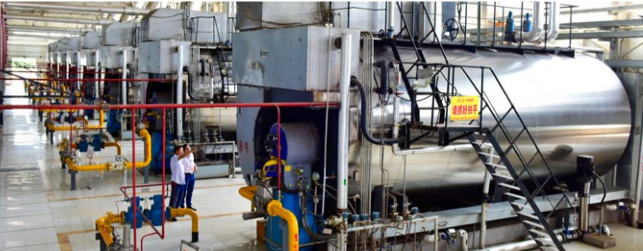
天然气锅炉，大幅度减少二氧化硫和氮氧化物及烟尘排放
