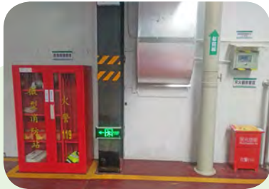
荆门园区设置微型消防站
