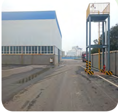
荆门园区新装消防水炮
