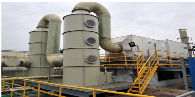
VVOCs 治理设施建成图
