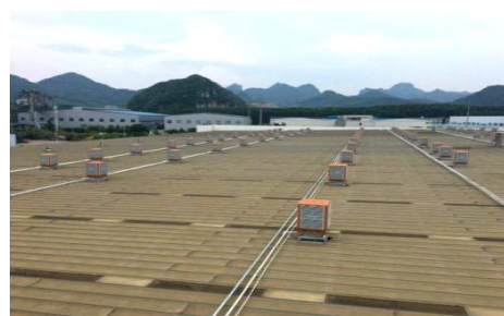
图 车间屋顶上的环保空调
