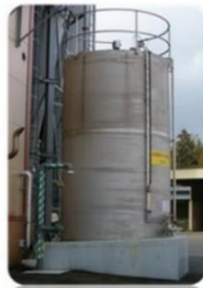
还原剂储存单元 RTU
