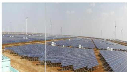
江苏响水 120 兆瓦渔光互补电站
