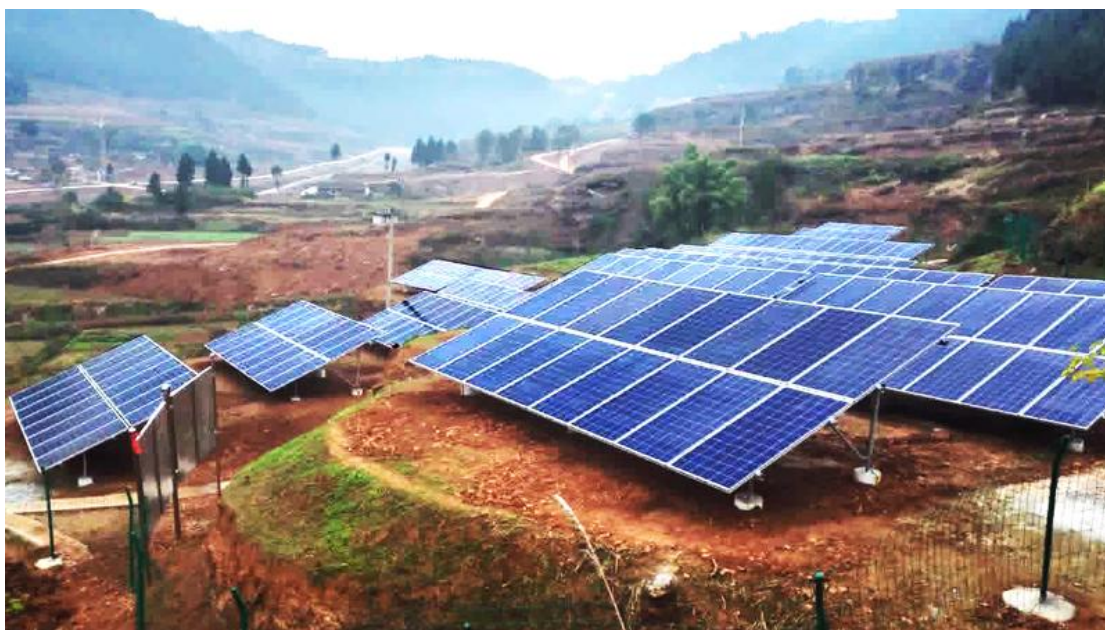
图：扶贫电站项目
