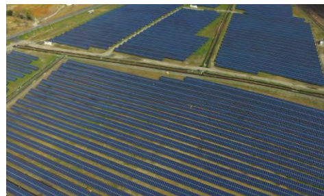
美国北卡罗来纳州 28MW 项目
