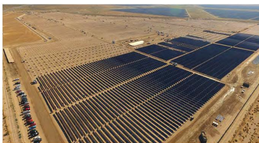
美国加利福尼亚州 107MW 项目
