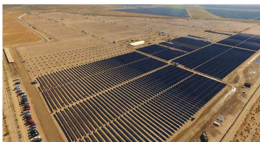
美国加利福尼亚州 107MW 项目
