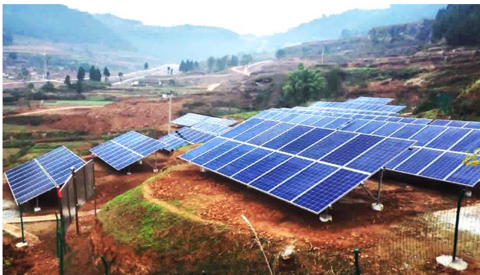
图：扶贫电站项目
