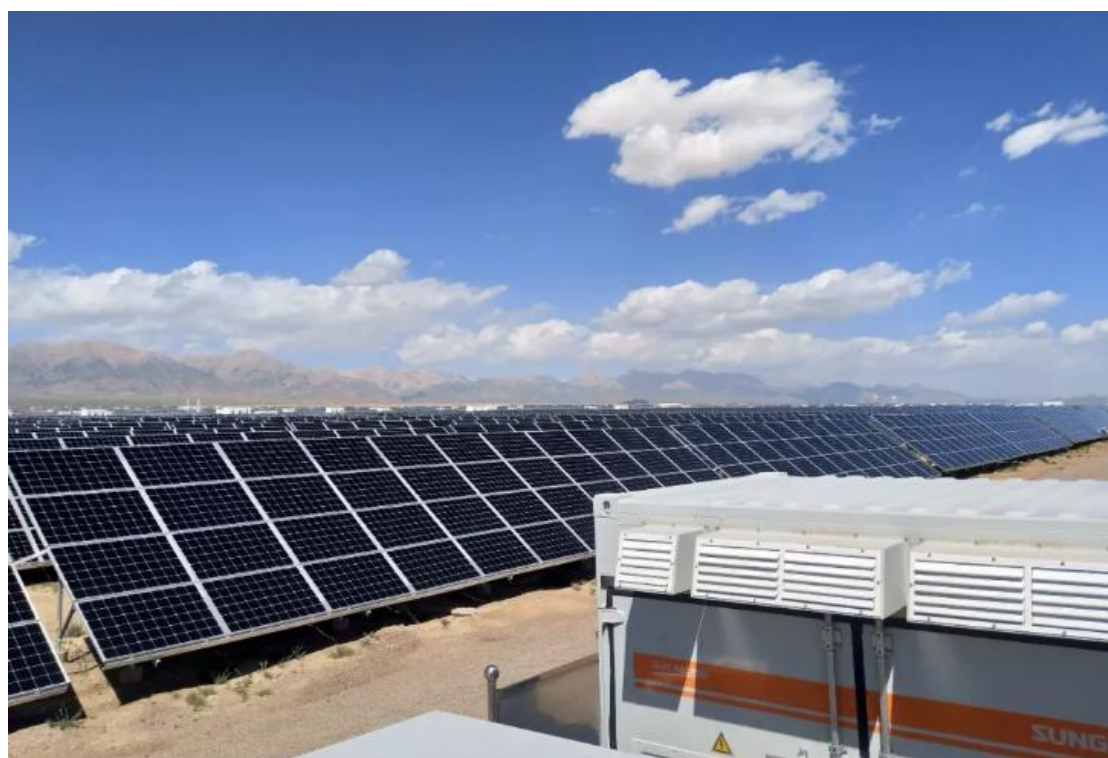
图：三峡集团青海格尔木光伏电站（平价上网）
