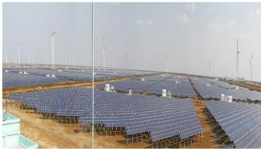
江苏响水 120 兆瓦渔光互补电站
