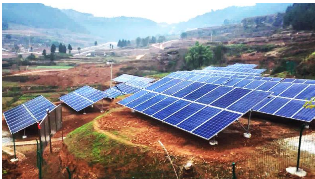
图：扶贫电站项目
