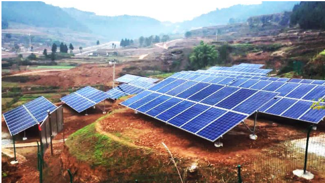
图：扶贫电站项目
