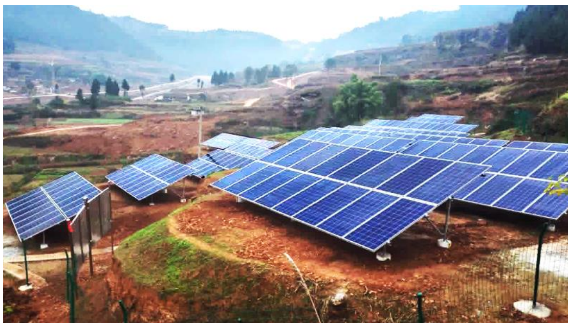
图：扶贫电站项目
