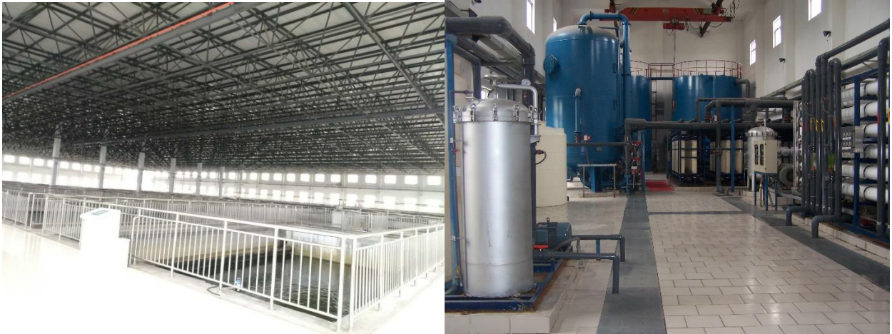
公司工业清水和除盐水生产系统
