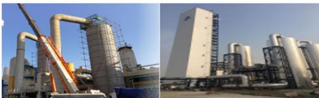
天安化工 5.2 万 Nm 3 /h 深冷空分装置
