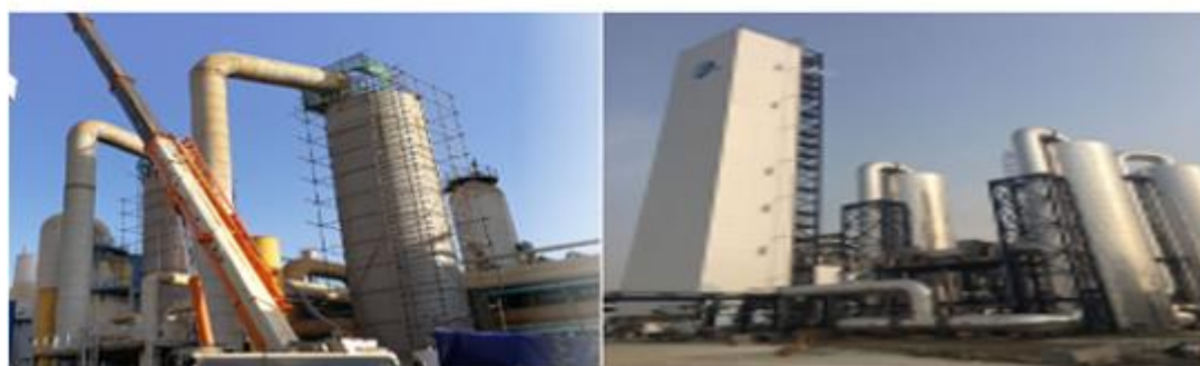
天安化工 5.2 万 Nm 3 /h 深冷空分装置
