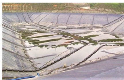
垃圾填埋场内渗滤液收集
