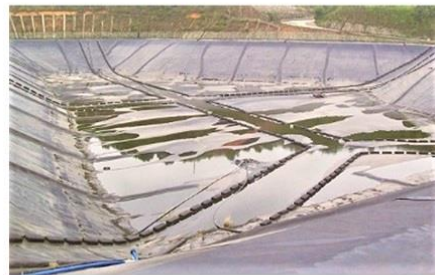
垃圾填埋场内渗滤液收集
