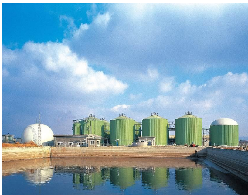
完成 CDM 交易的农业领域大型沼气发电项目 科技部“十一五”科技支撑计划示范项目 世界银行碳减排交易项目
