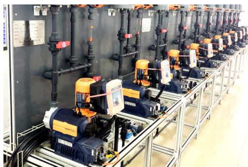
次氯酸钠改造项目
