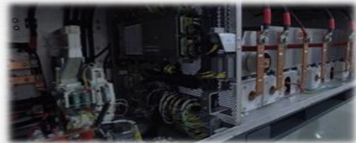
车辆牵引供电系统
