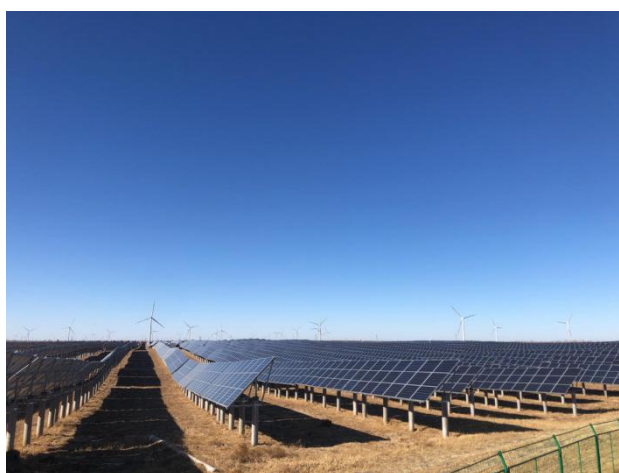
深能内蒙古开鲁光伏扶贫项目
