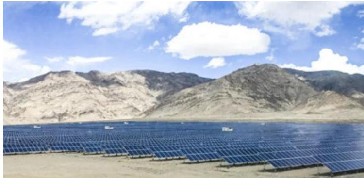
深能福塔光伏扶贫项目
