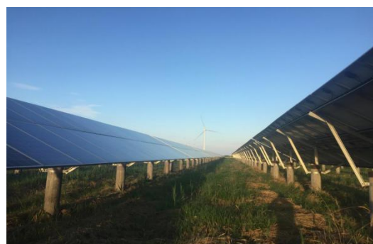
南控光伏项目
