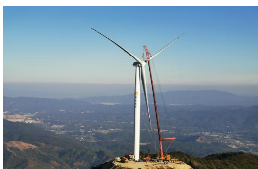
南控风电项目
