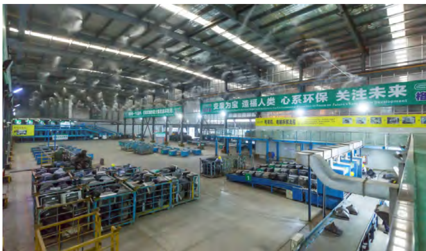
电子废弃物喷雾降温降尘系统
