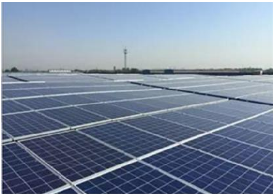
2017 年 1 月，公司第一个屋顶分布式光伏发电项目——徐州金驹项目成功并网发电。
