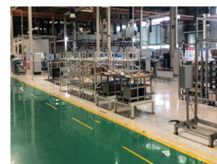
油封库和冷试库分拣系统
