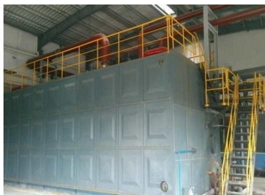
改造后的燃气锅炉
