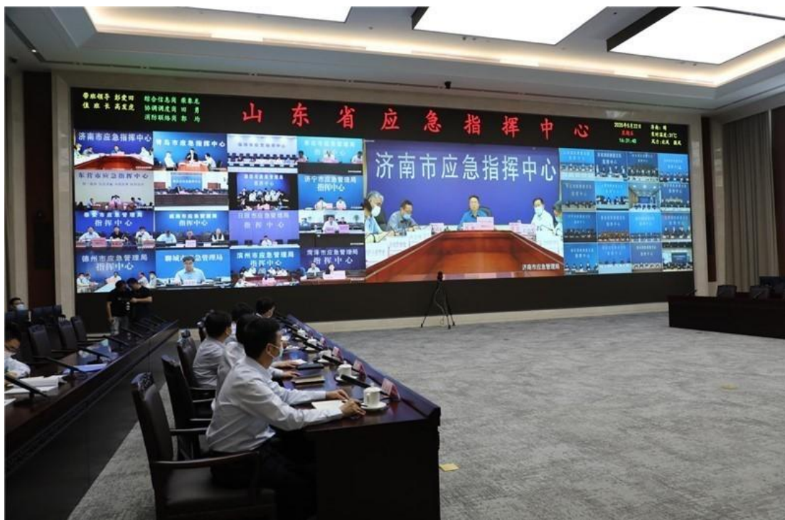
山东省应急管理厅应急指挥中心视频会议现场 (P0.9, 116.75m 2 )
