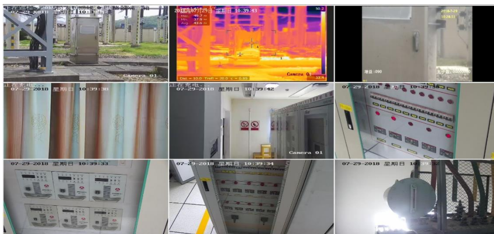
图：智能巡检系统全站监控
