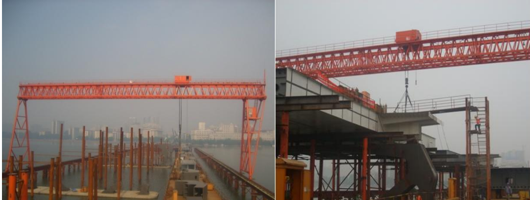
图例：使用“基于龙门吊的内湖梁式钢桥安装技术”的武汉八一路延长线光谷大桥项目施工现场
