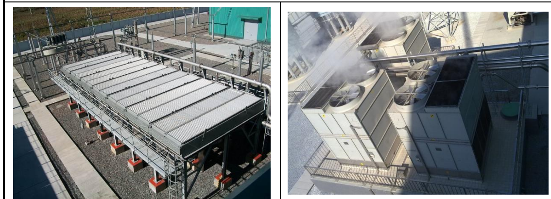
空冷器、冷却塔外观
