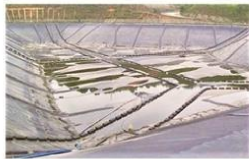
垃圾填埋场内渗滤液收集
