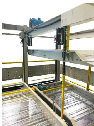
应用场景：立体车库
