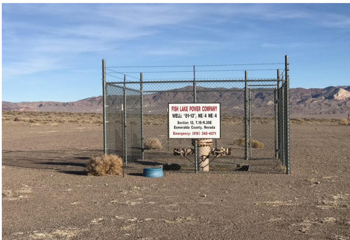
图片 3：保存完好的地热井
