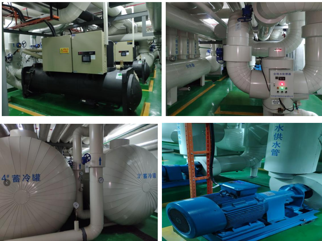
机房高效节能系统
