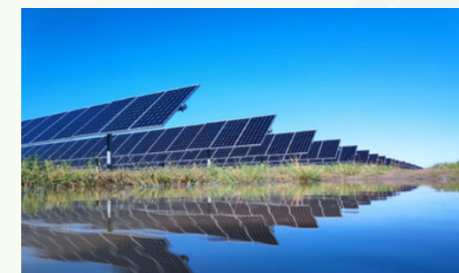
张家口市光伏电站项目
