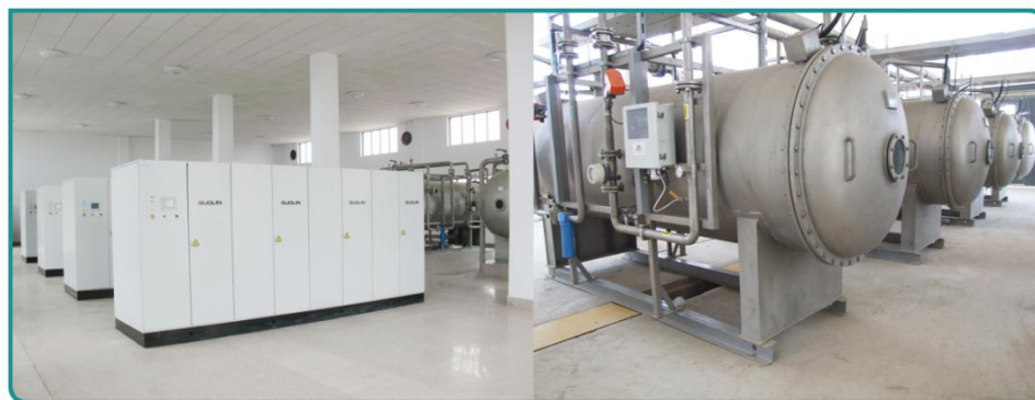
（臭氧电源柜）（臭氧发生室）
