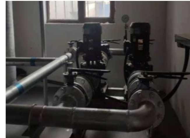
冷却水补水系统更新改造
