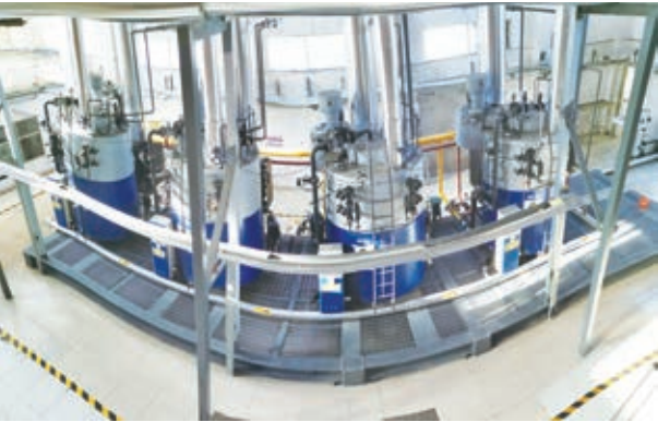
福州工厂煤改气
