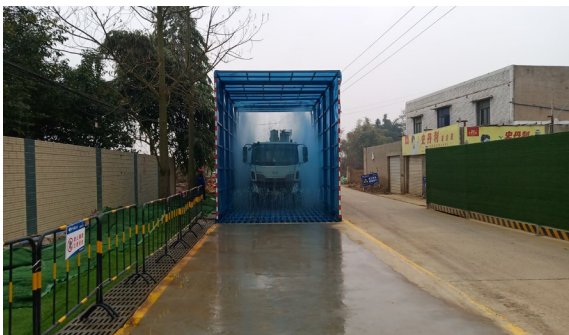
立体全方位车辆冲洗装置
