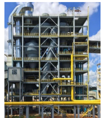
越南仁基氧化铝工程项目——焙烧炉
