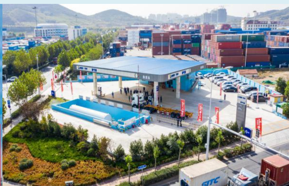
前湾南港区新建 LNG 加气站
