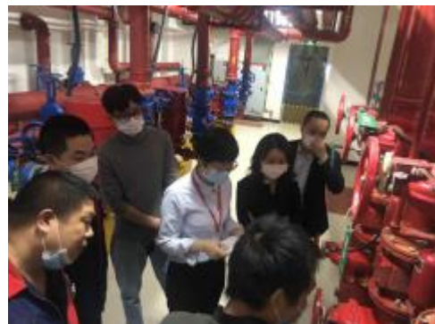
办公楼消防设备系统检测
