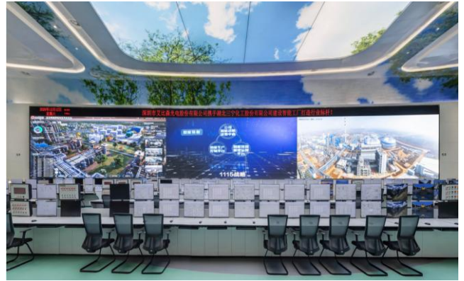
湖北三宁化工智慧园区中央控制室（KL1.8）
