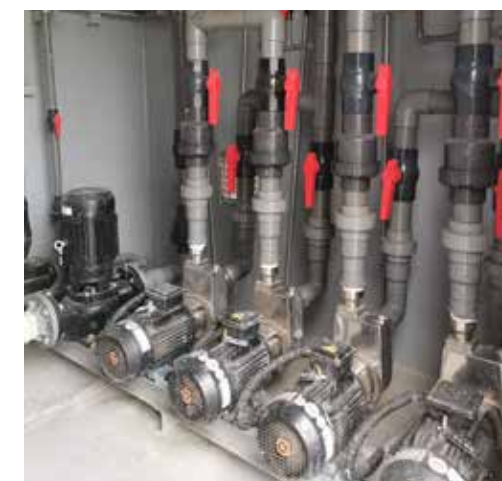
▲ 污水处理设备
