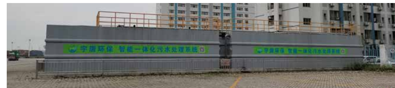
▲ 15T 污水处理站
