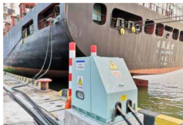
▲ GCT 岸电设备
