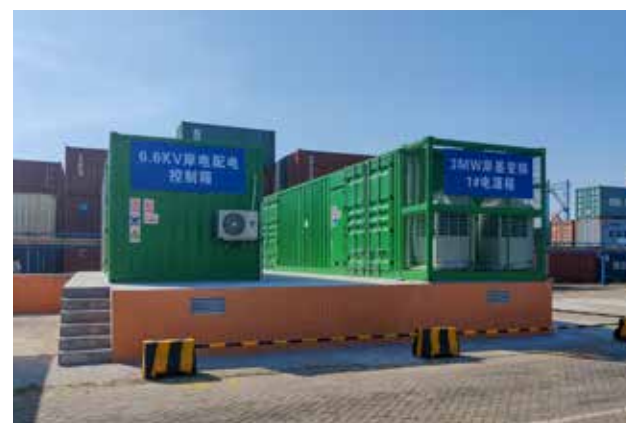
▲ 南沙海港集装箱码头岸电设备
