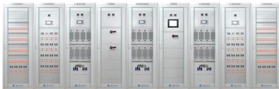
电力操作电源系统（一体化电源系统）
