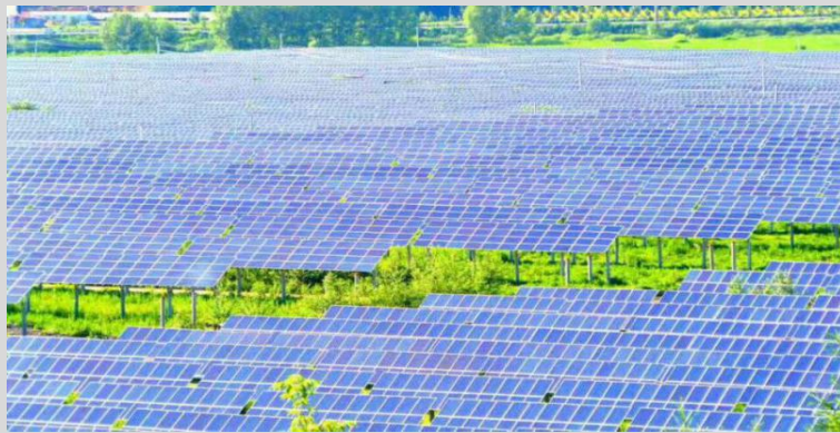
深能吉林白山农业光伏扶贫项目
