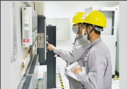
惠州燃气做好生产保障措施，保障居民、工商业用户安全稳定用气
