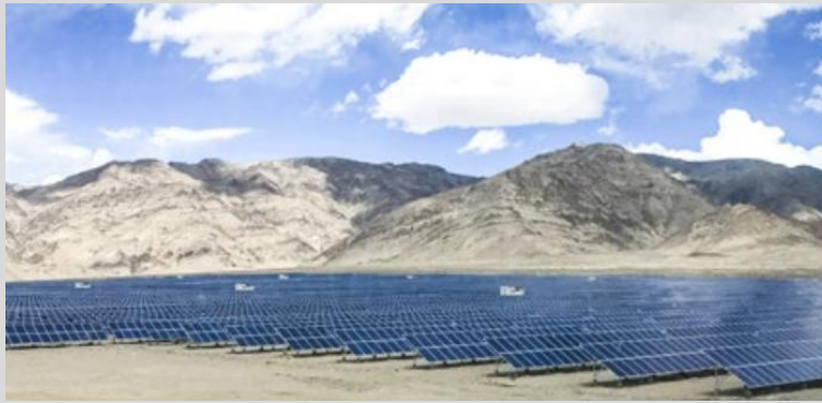
深能福塔光伏扶贫项目
