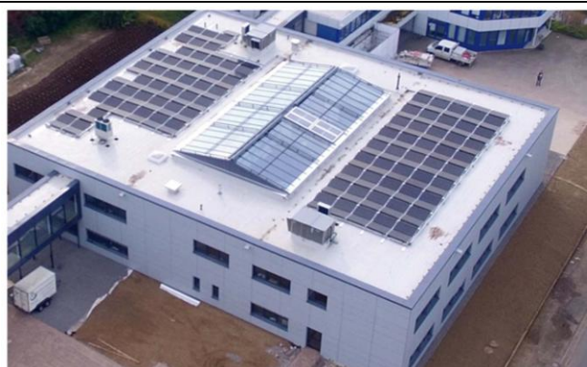
德国子公司 HMF 办公楼顶的光伏发电系统
