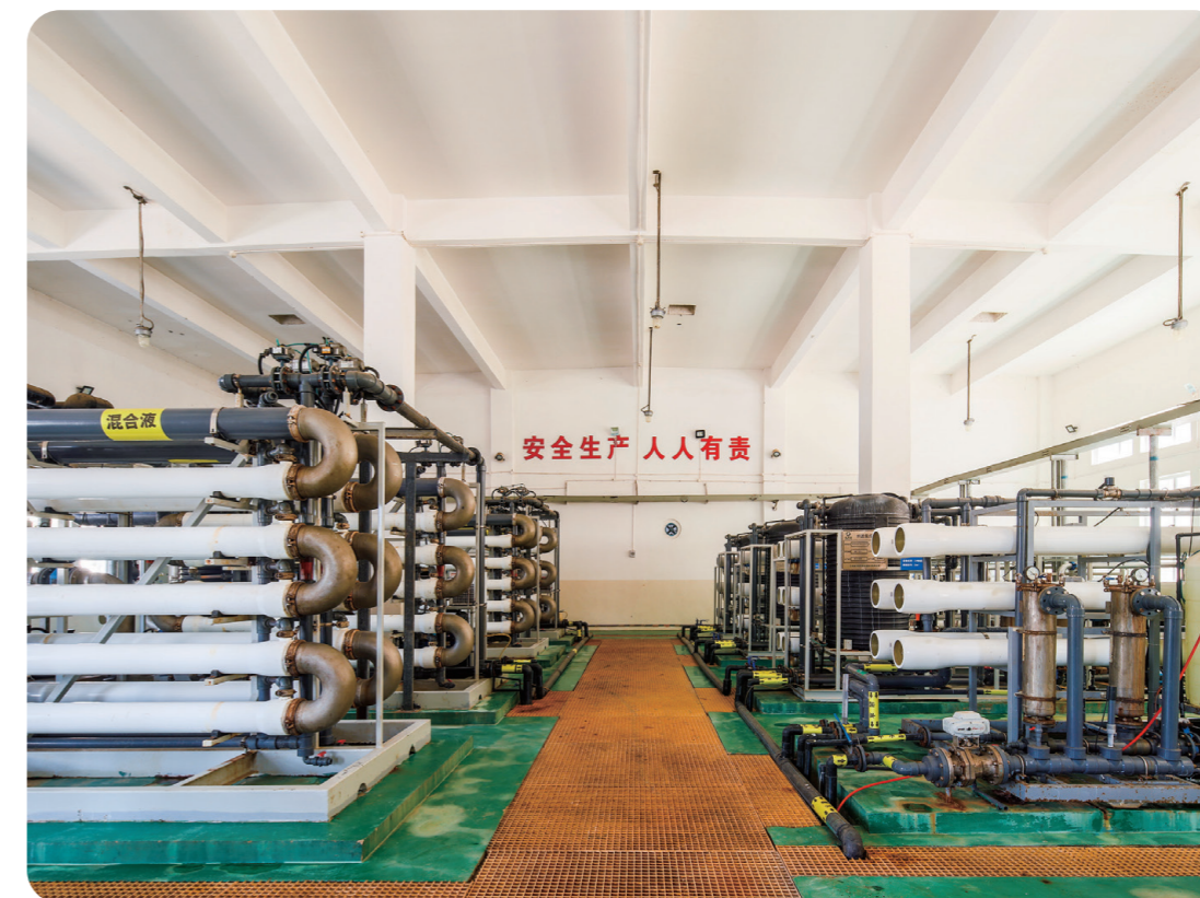
液渗滤液厂二期膜处理车间
