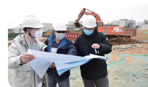
兴蓉环境下属第九再生水厂提标改造项目改造完成后，出水水质由《城镇污水处理厂污染物排放标准》(GB18918-2002) 一级 A 标提升至《四川省岷江、沱江流域水污染物排放标准》(DB51/2311-2016)
