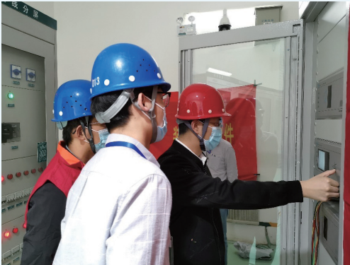
自主可控成套装置在变电站挂网运行
