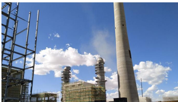
（新疆天盈化工锅炉烟气氨法脱硫超净排放）
