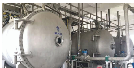
市政污水治理--嘉兴市联合水务污水处理提标改造工程
