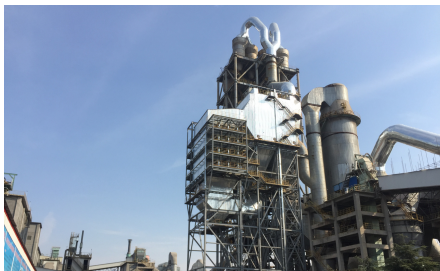
国内首套示范工程 河南宏昌水泥SCR脱硝工程
